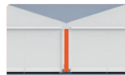
Koppelgoot tussen aluhallen
